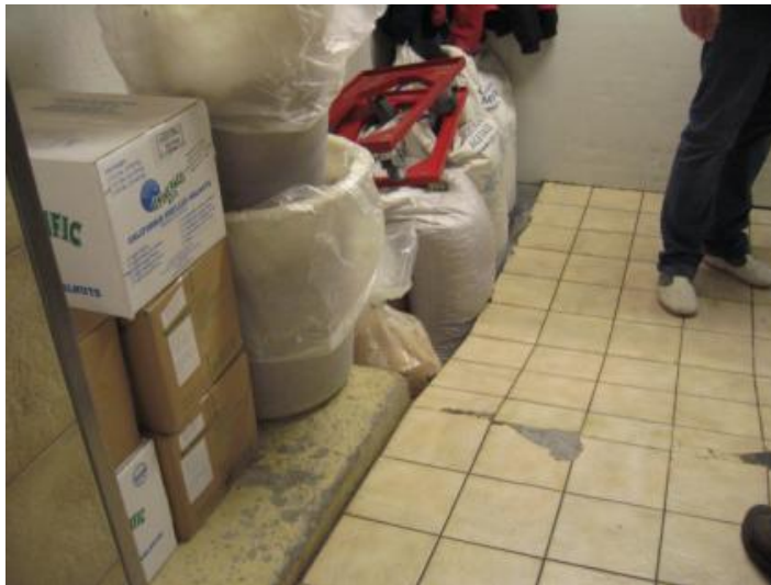
Abbildung 3: Defekter Boden in der Backstube
