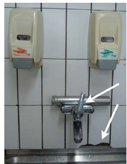
Abbildung 8: Defekte Fliessen und kein berührungsfreier Wasserhahn.
